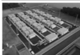
豊前蓄電池変電所 電力貯蔵用NAS電池 三菱電機ニュースリリース 2016年3月3日より
